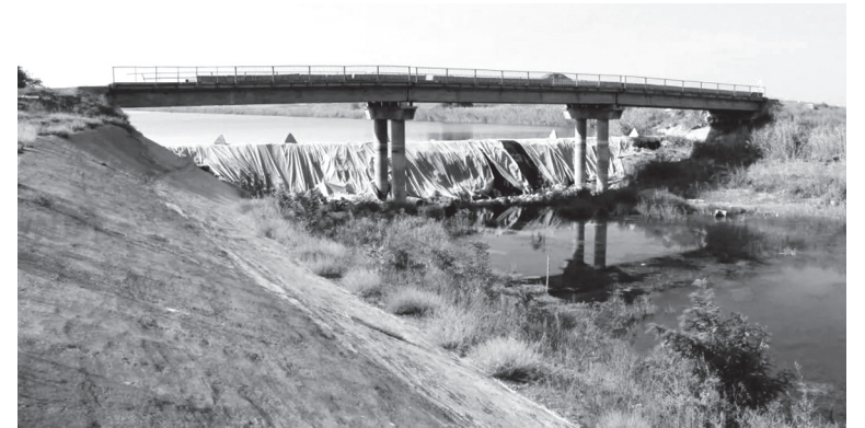
Ділянка Північно-Кримського каналу поблизу селища Каланчак Херсонської області, вересень 2015 року. Після окупації Криму подача води каналом була припинена. Фото: Олександр Білокобильський
